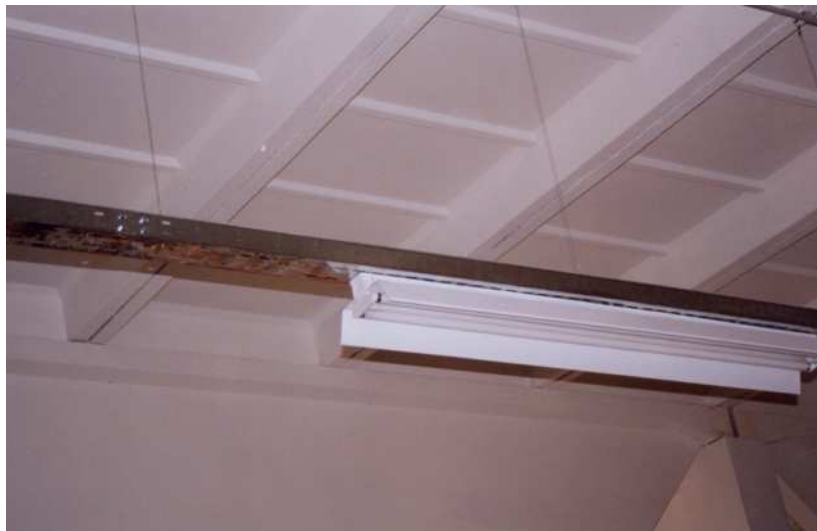
• Obrázek 2: Zářivkové osvětlovací těleso pod běžným děrovaným kabelovým žlabem
