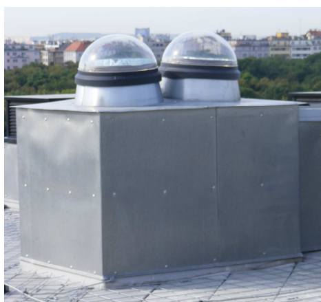
Obr. 2 – Nástřešní kopule světlovodu
